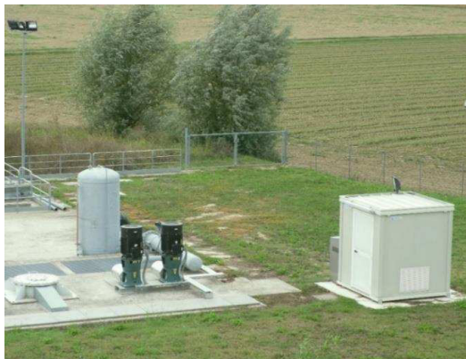
Stazione di pompaggio tipo
