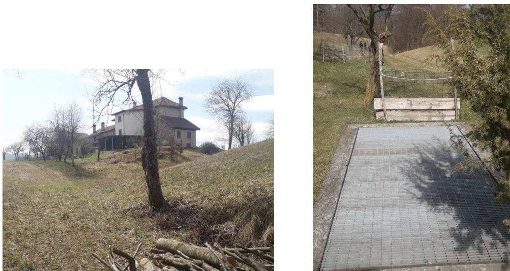
Fig.5 – Particolare dell'area a monte del coronamento dove è visibile l'opera di drenaggio. Sopralluogo 2019.
