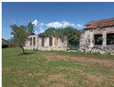
I fabbricati ad uso legnaia, fienile e deposito attrezzi di Villiago – BL di cui si prevede la ristrutturazione
