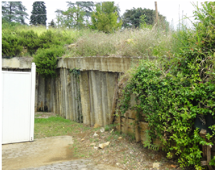
Fig. 3 – Opera di contenimento interessata da lesioni.
