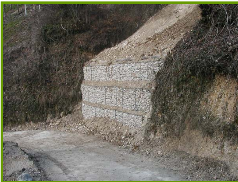
Sostegno al piede e consolidamento pendici in frana (S.F.R. di Treviso e Venezia)
