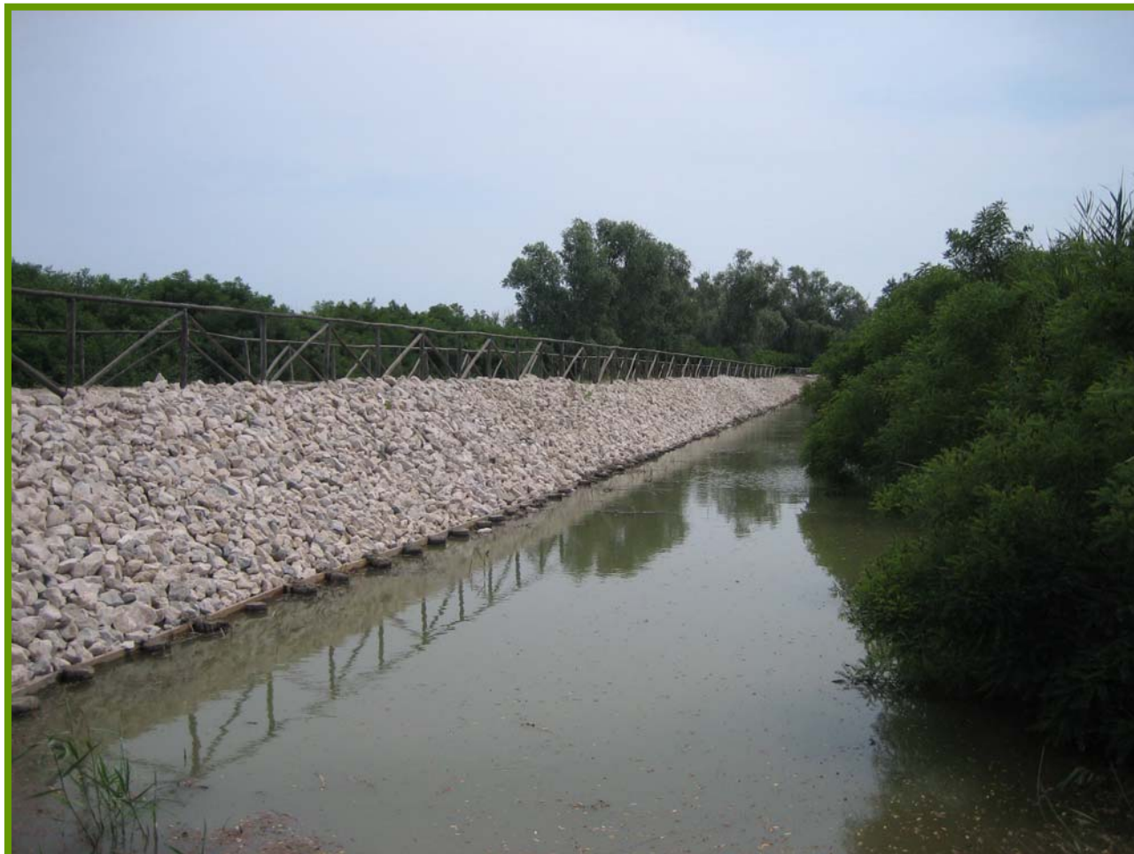
Intervento di sistemazione spondale – Loc. Golena di Ca' Pisani (S.F.R. di Padova e Rovigo)
