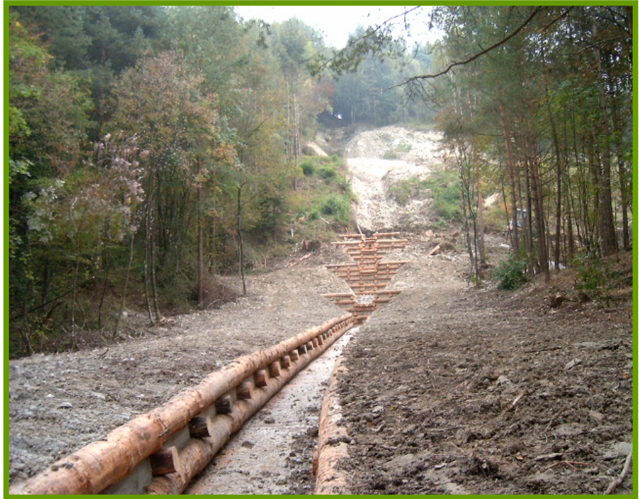
Sistemazione longitudinale di sponda (S.F.R. di Belluno)
