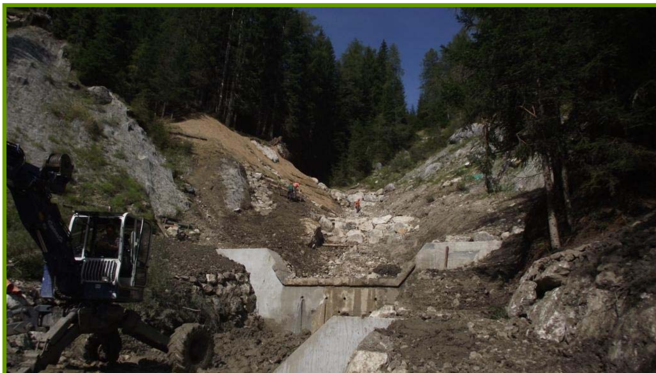
Intervento integrato di sistemazione d'alveo e di consolidamento di versante (S.F.R. di Belluno)
