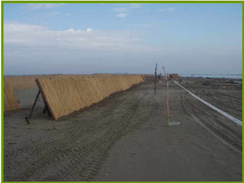
Intervento di difesa di cordoni dunosi litoranei dall'azione erosiva del vento in corso di realizzazione (S.F.R. di Padova e Rovigo)
